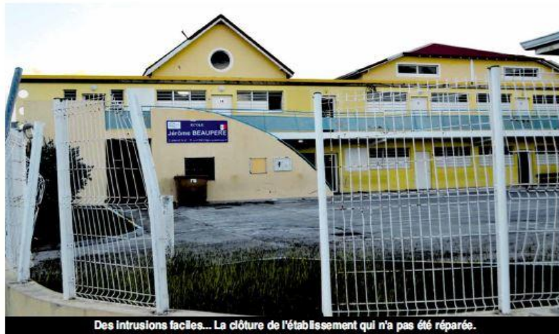
Des intrusions faciles... La clôture de l'établissement qui n'a pas été réparée.
